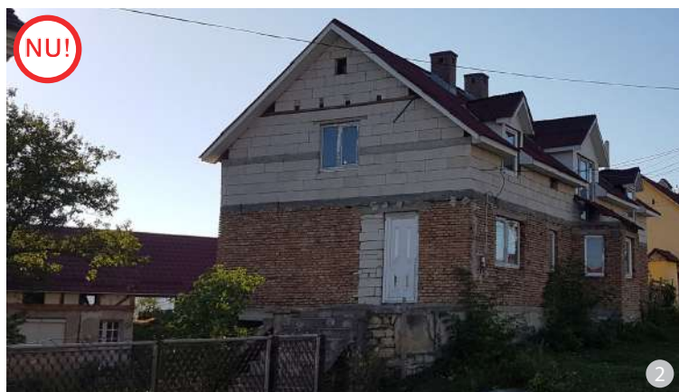
AȘA NU: Materialele de slabă calitate folosite pentru construcțiile noi sau pentru extinderi ale construcțiilor existente nu se ridică la standardul impus de materialele tradiționale, putând duce la deteriorări ale elementelor constructive.
